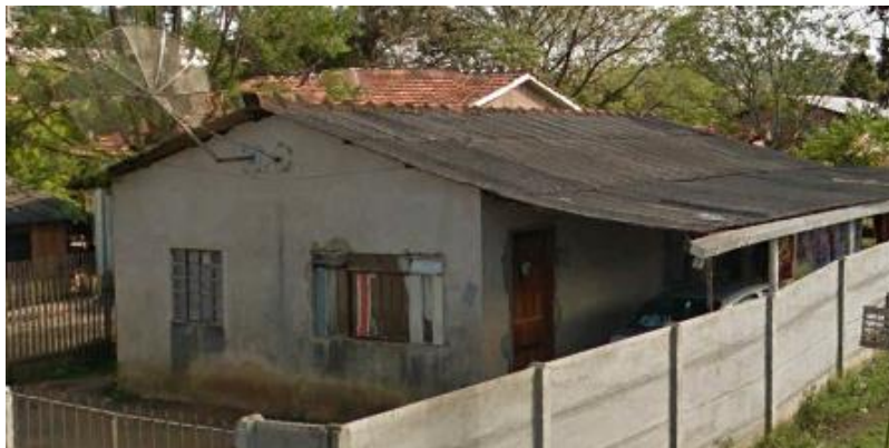
FIGURA 16 – Residência suscetível a destelhamento no Bairro Ronda.
